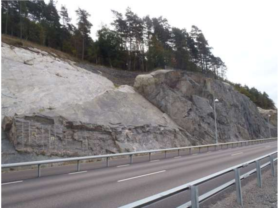
Figur 69. Denna skärning projekterades 5:1. Bilden visar att naturliga slagen i berget stupar ca 1:1. Konsekvensen att välja 5:1 slänt blev en dyr bergförstärkning med förspända stag som inte fanns upptaget i handlingarna.
