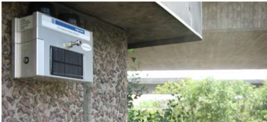
Figur 49. Exempel på en mätutrustning som monterats på en husgrund (Foto Nitro Consult)
