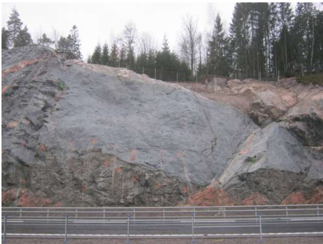
Figur 68. Denna skärning hade omfattande storstabilitetsproblem som man inte tog hänsyn till i byggskedet. Denna åtgärdades efter trafiköppnande på grund av att man fick ett ras i skärningen, och då utnyttjades de branta befintliga slagen istället, vilket resulterat i en stabil slänt. Att göra sådant i efterhand är dock mycket kostsamt och skall i största möjliga mån undvikas.
